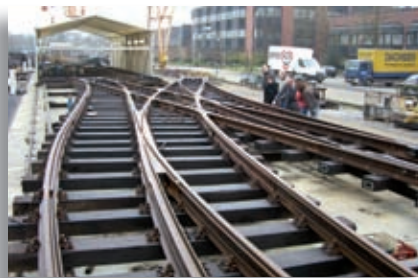
Vormontierte, komplexe Weichenanlage auf dem Außengelände der Weichenwerkstatt der Rheinbahn AG.
